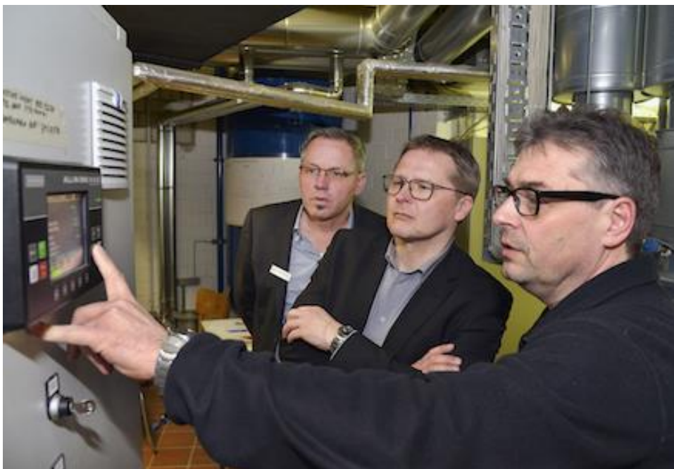
Inbetriebnahme des BHKWs im Kreishaus durch die Abteilung Immobilien und Kreisarchiv im Dezernat Finanzen, Soziales und Immobilien Foto: Kreis Soest/Weinstock
